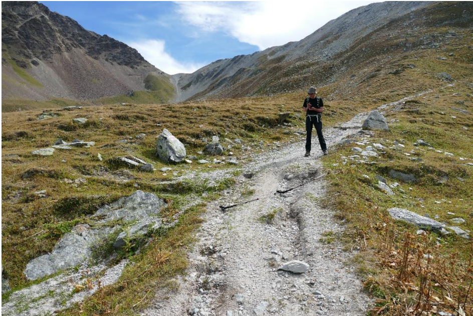
Abbildung 1: Wegabschnitt unter den Serpentinien vor der Instandstellung.
