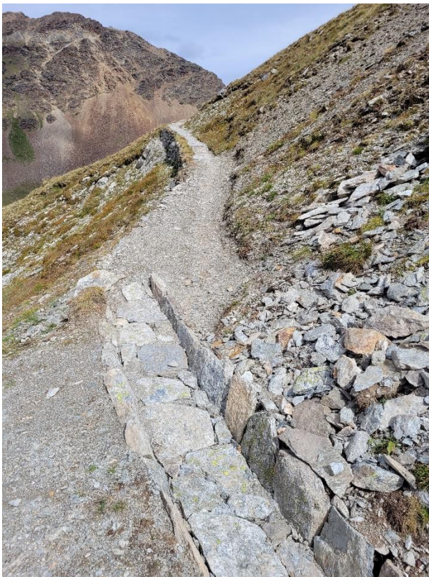
Abbildung 9: Beispiel eines reparierten Querabschlags im Bereich der Serpentin.
