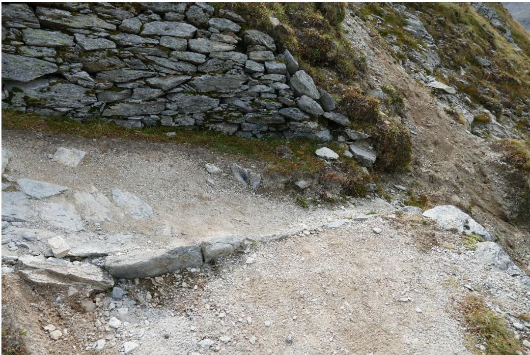
Abbildung 5: Starke Erosion durch Wasser und beginnender Zerfall der Stützmauer von Serpentine Nr. 8.
