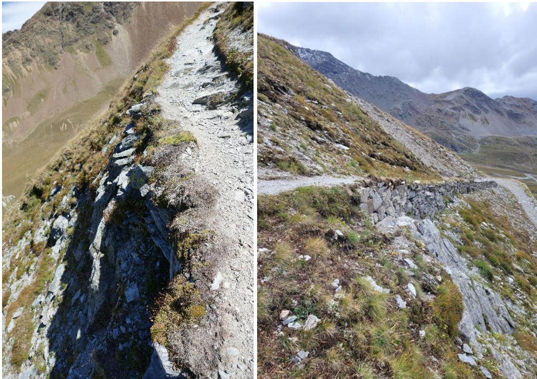
Abbildung 8: Stark beschädigte Mauerpartie am unteren Rand des Weges. Weggebrochene Mauerkrone und Erosion der Wegoberfläche. Im Bild rechts dieselbe stelle in instandgesetztem Zustand.
