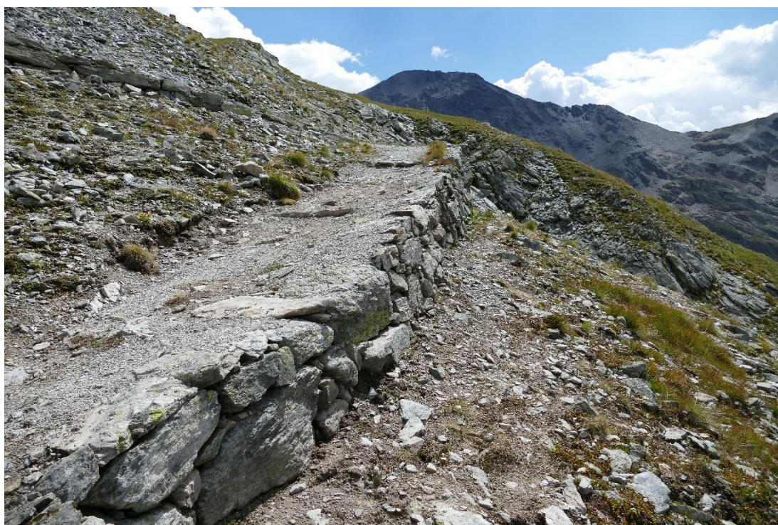
Abbildung 9: Derselbe Abschnitt weiter oben. Diese «kleineren» Reparaturen wurden an verscheiden stellen des Weges im Bereich der Serpentina ausgeführt.
