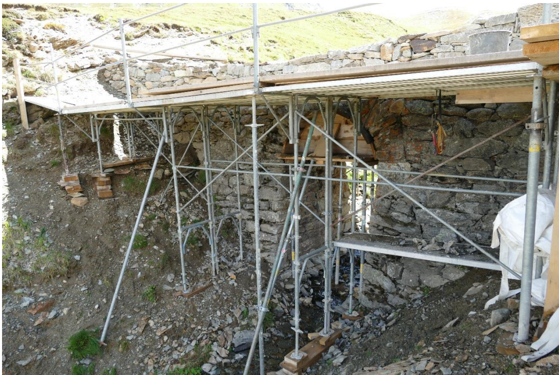
Abbildung 2: Die Brücke während der Instandstellung. Am "Fuss" der Brücke wurde der das Wasser mit grossen Steinen vom Fundament weggelenkt.
