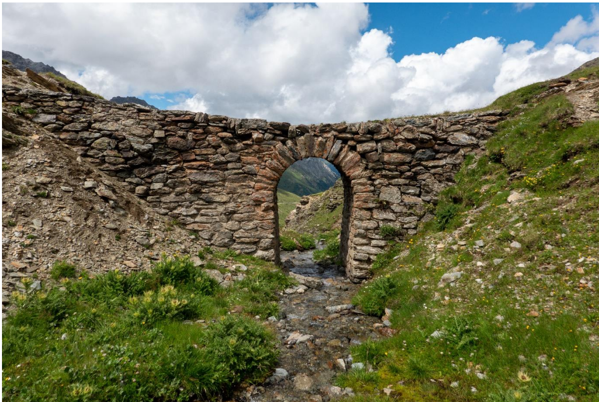
Abbildung 1: Brücke über die Muranzina vor der Instandstellung. Im linken Bereich «baucht» die Mauer. Aus der Mauerkrone sind Steine herausgefallen. Die Muranzina fließt im rechten Bereich direkt an die Fundamentsteine und beginnt diese zu unterspülen. Bild: C. Doswald
