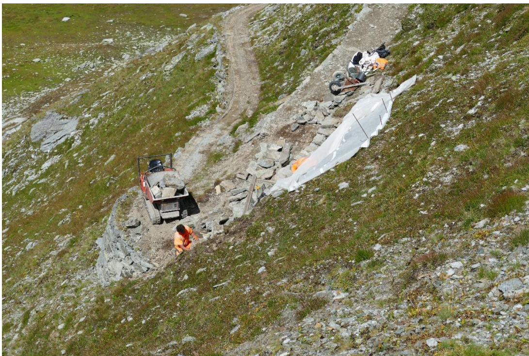
Abbildung 7: Blick von der nächsten, höhergelegenen Kurve in den Serpentin. Die Herausforderungen der Baustelle sind aus dieser Perspektive gut zu erkennen.
