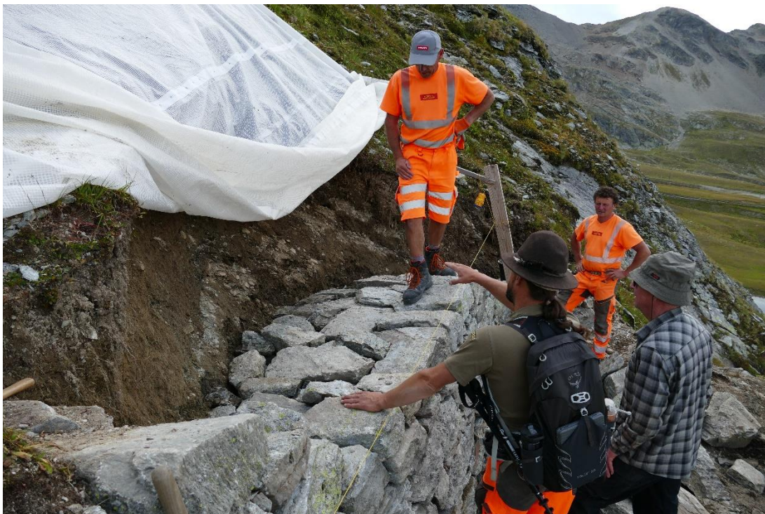
Abbildung 6: Besprechung der Ausführung mit dem Sachverständigen für historische Verkehrswege. Gut zu sehen ist die Hintermauerung, welche die Stützfunktion massgeblich gewährleistet.
