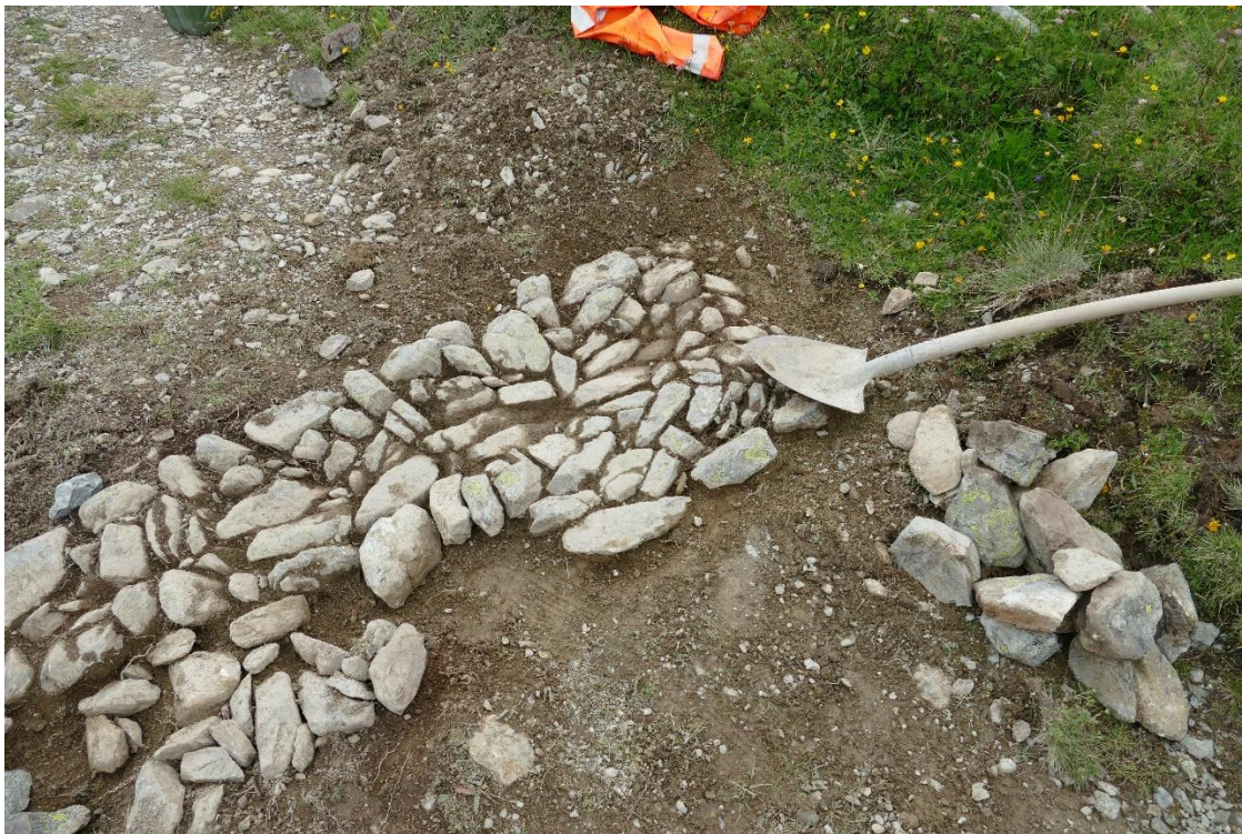
Abbildung 7: Freigelegter, defekter Querabschlag.
