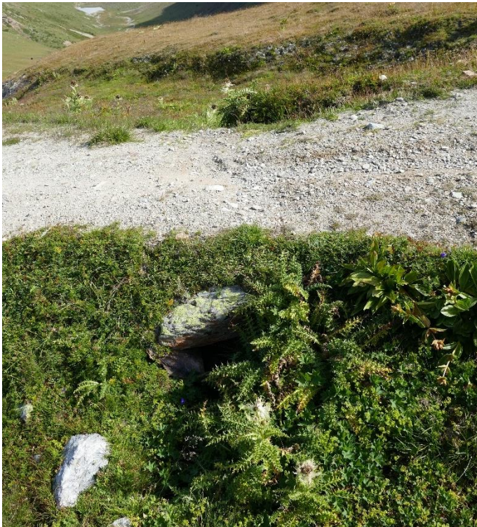
Abbildung 10: Im Innern eingestürzter Wasserdurchlass.
