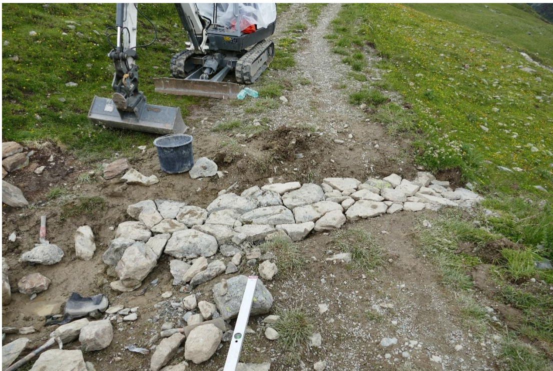
Abbildung 8: Die Instandstellung der Querabschläge in der ursprünglichen Machart ist aufwändig und verlangt handwerkliches Geschick.
