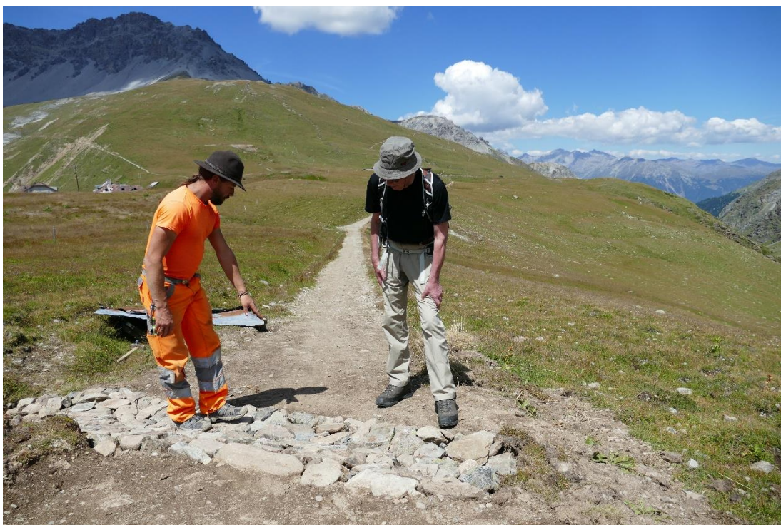
Abbildung 9: Abnahme und Diskussion eines Musterobjektes. Links im Bild der Vorarbeiter Dario Fallet. Rechts im Bild der Fachexperte Cornel Doswald.
