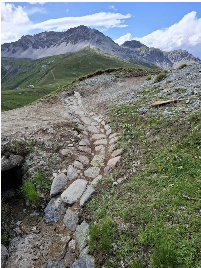
Abbildung 3: Langer Querabschlag zum Schutz eines Wasserdurchlasses vor Erosion.
