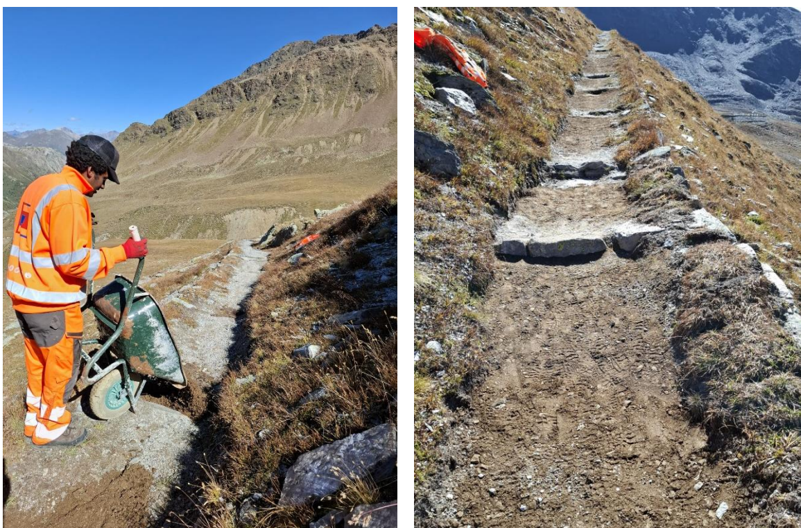
Abbildung 6: Stark erodierte Stellen im Weg mit Rinnenbildung wurden mit lokal vorhandenem Material aufgefüllt und Stufen eingebaut, um das Material vor Ort zu halten.
