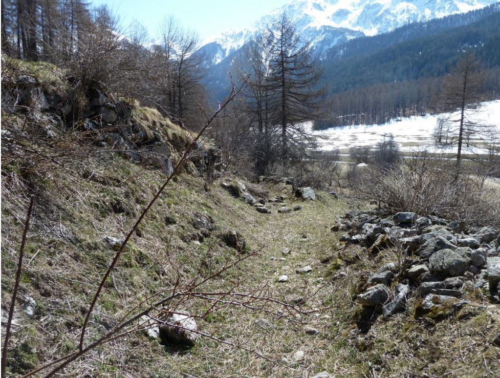
Abbildung 4: Situation von oben nach unten betrachtet vor der Instandstellung.
