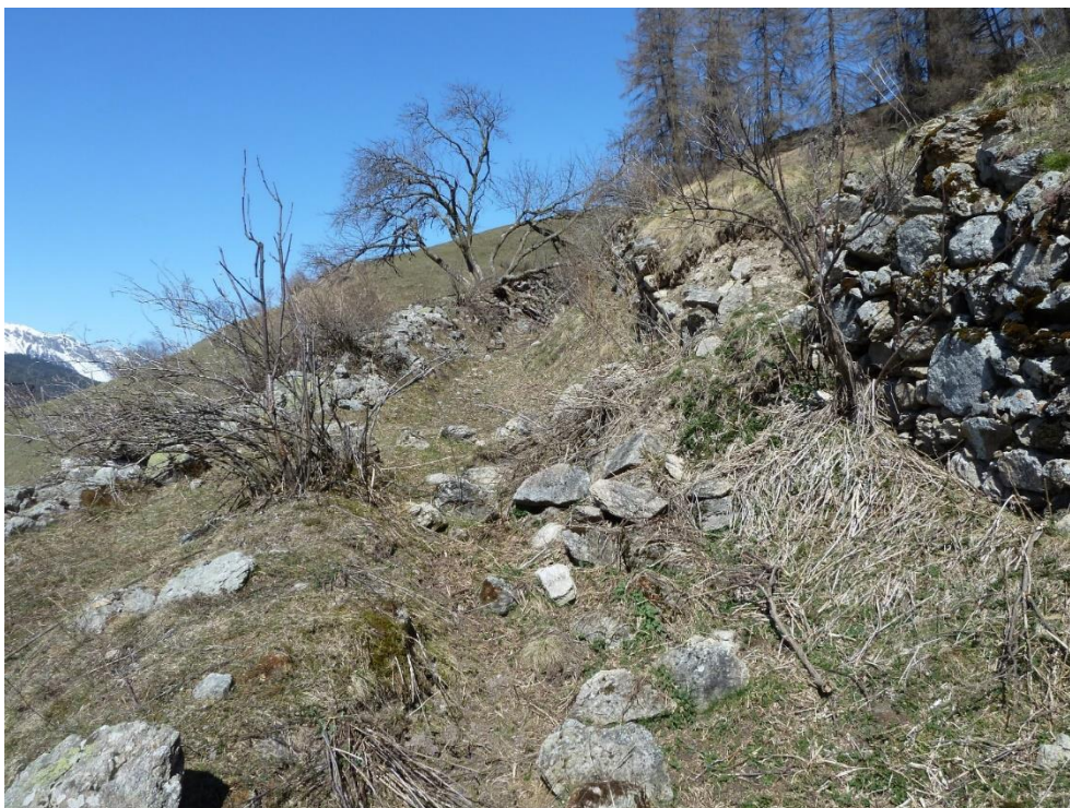
Abbildung 3: Situation im oberen Bereich des Bauabschnittes vor der Instandstellung.
