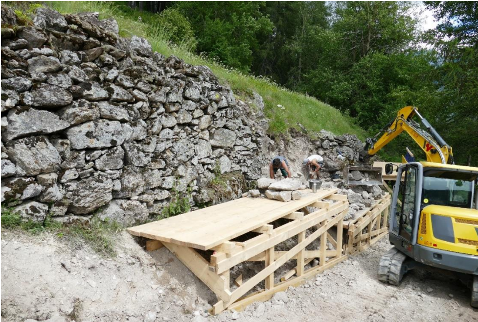
Abbildung 10: Anspruchsvolle Instandstellung eines Mauerabschnittes zwischen zwei "intakten" Abschnitten.
