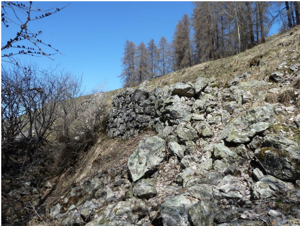
Abbildung 1: Unterer Bauabschnitt vor der Instandstellung.
