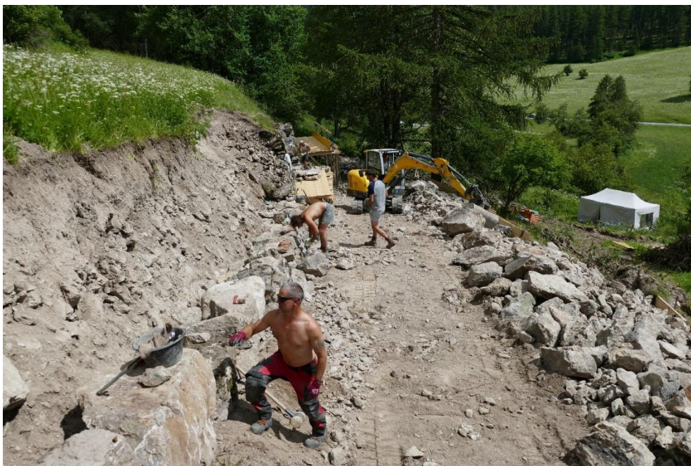
Abbildung 9: Teilweise musste die Mauer neu aufgebaut werden, um eine ausreichende Stabilität zu erhalten. Es wurden keine neuen Steine zugeführt.
