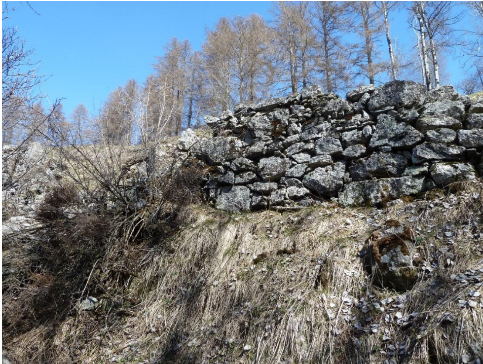
Abbildung 2: Noch einigermaßen stabiler Mauerabschnitt vor der Instandstellung.
