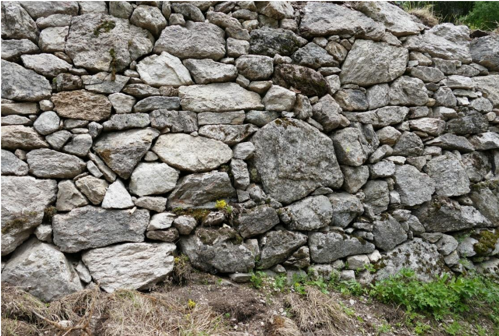
Abbildung 14: Detail eines Mauerbildes.
